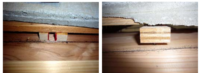
写真-2 通気胴縁の破壊状況(左:すぎ製材, 右:合板)
