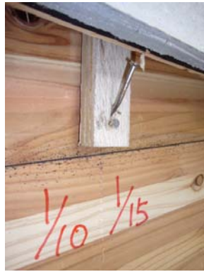
写真-3 N65の抜け・変形
