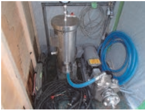
写真7 膜ろ過装置の外観
