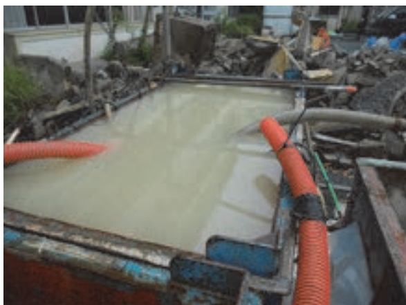
図2 石綿含有汚染水(原水)
