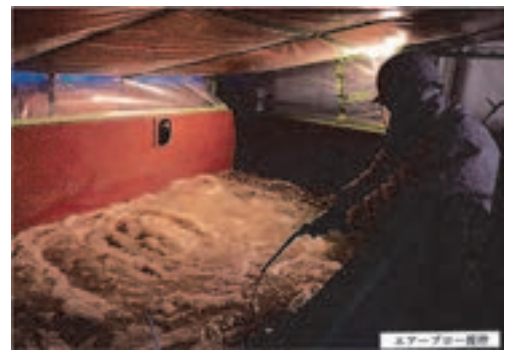
写真4 エアブロー機操作
