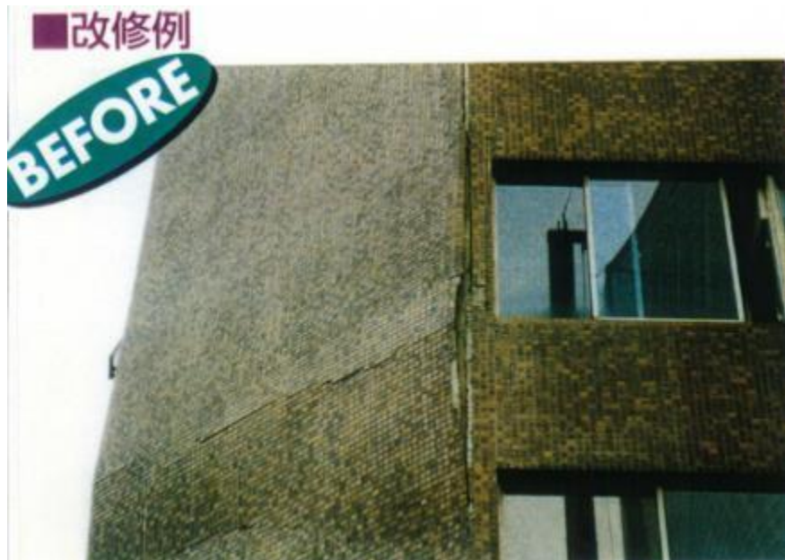
磁器タイル 剥落、漏水
