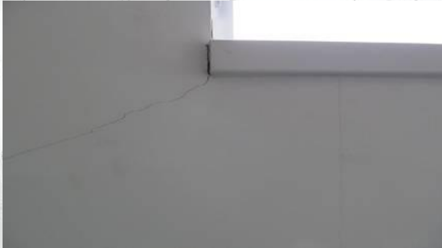
塗り壁のひび割れ
