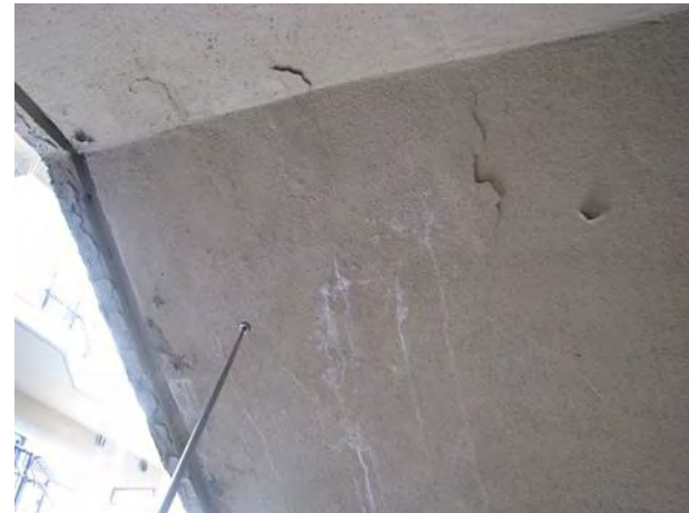
外階段裏面に発生したエフロレッセンス
