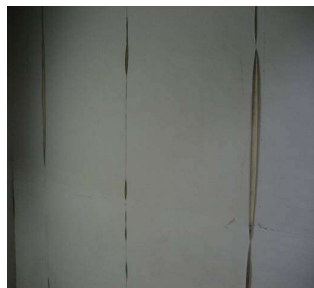
貼り合せ部の剥がれ
