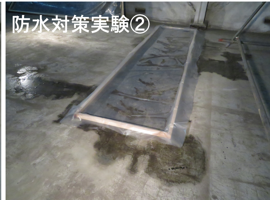
0.15mm厚ポリエチレン2重張りの 複数箇所から漏水発生
