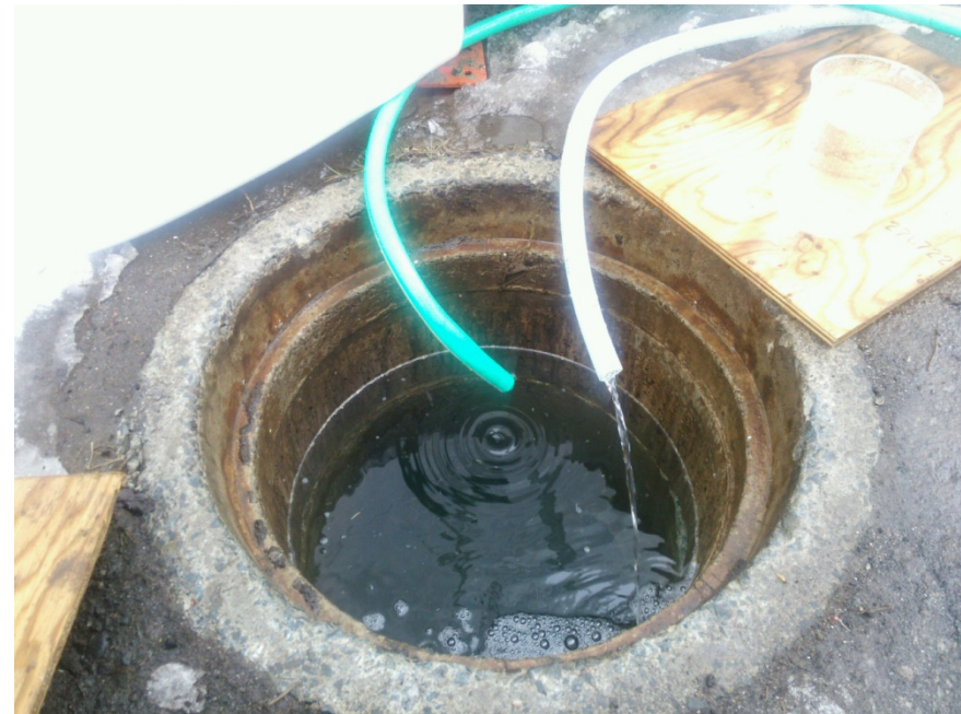
処理した汚水を下水道へ放流
