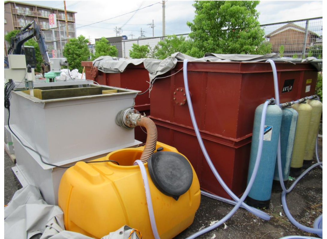
排水沈殿濾過装置
